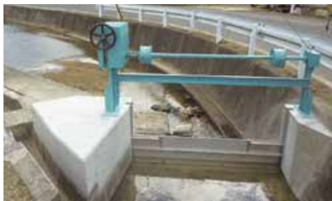
ワイヤー巻き上げ式樋門
