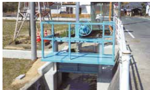
ラック式樋門
